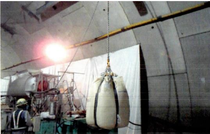
コンクリートを製造中のスーパーMP21A2と投入準備中のDM
