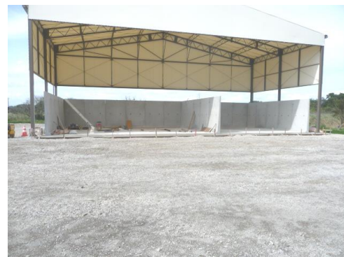
災害用 生コンプラント骨材ヤード
